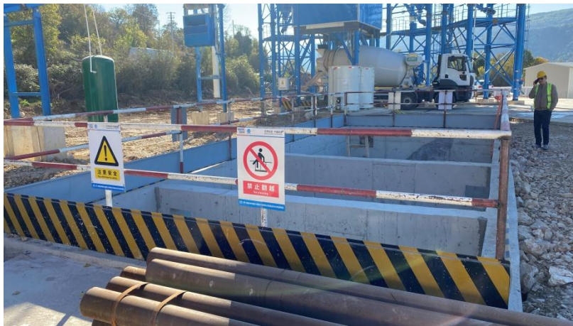
Slika br. 5: Trokomorni taložnik otpadnih voda na lokaciji betonare CGGC
