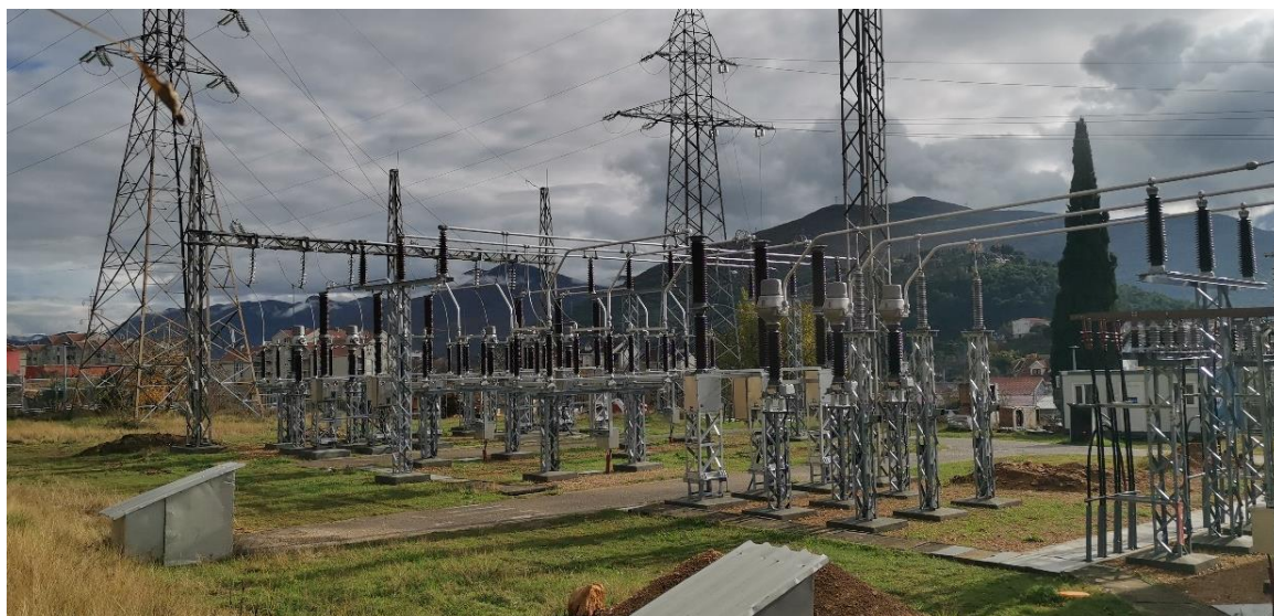
Slika 4. Priključak dalekovoda u TS Trebinje 1
